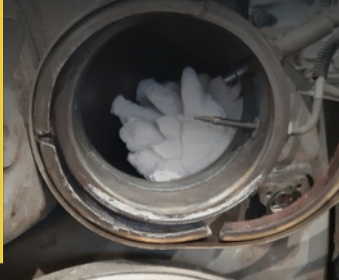
4. AdBlue-pinnoitus injektio alla 180°C
