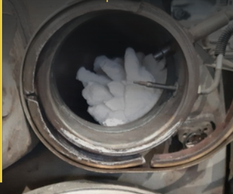
4. depuneri cauzate de injectarea AdBlue la temperaturi sub 180°C
