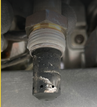
2. deteriorarea cablului în conducta de alimentare
